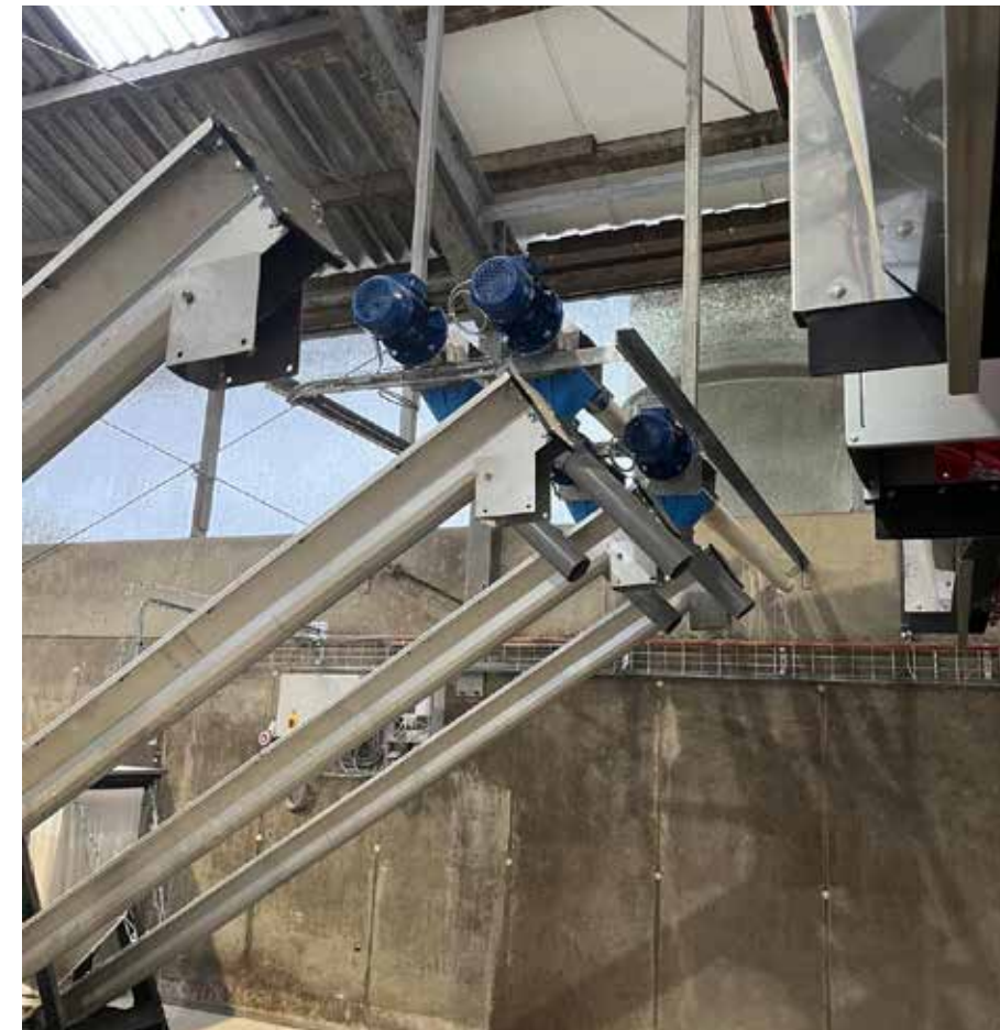
Silo Box besturing t.b.v. aansturen externe silo's
